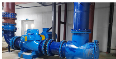
南昌第二製造中心通過水泵改造年節省約90萬度電
